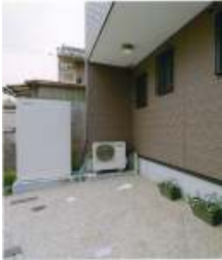
省エネ、省コストの高効率給湯機 エコキュート(フルオートタイプ) 京田辺市田辺 T邸
